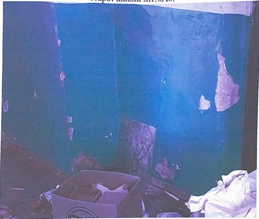
Фото 35: Руйнування внутрішнього опорядження приміщення №13 будівлі старої школи літ.«А».
