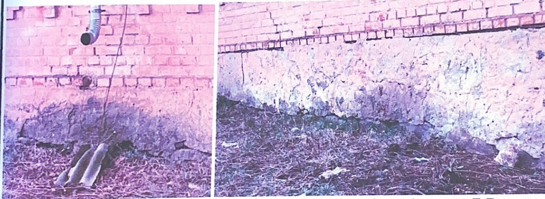
Фото №29,30 : Розмиття фундаменту прибудови літ. «А1» в осях Б-В.
