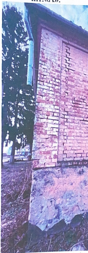
Фото №19: Відсутні труби на усю висоту стіни прибудови літ. «А1».
