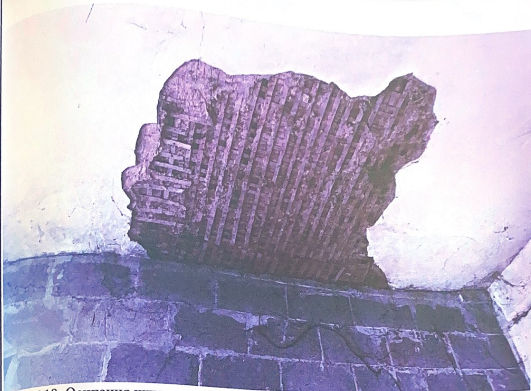
Фото №18: Осипання штукатурки перекриття в приміщенні 27 будівлі старої школи літ. «А».
