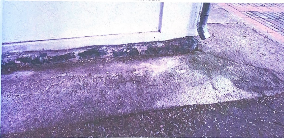
Фото 32: Руйнування вимощення та фундаментів на перетині осей «А» і «8», будівлі старої школи літ.«А».
