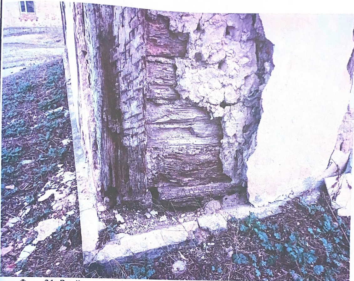
Фото 31: Зруйнований фундамент в куті будівлі на перетині осей «Д» і «1», враження стіни комахами, зруйнована в основі стійка каркасу будівлі старої школи літ.«А».
