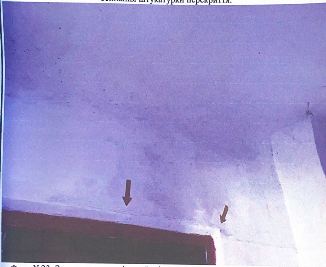
Фото №23: Замокання внутрішньої стіни в приміщенні 13 будівлі старої школи літ.«А».
