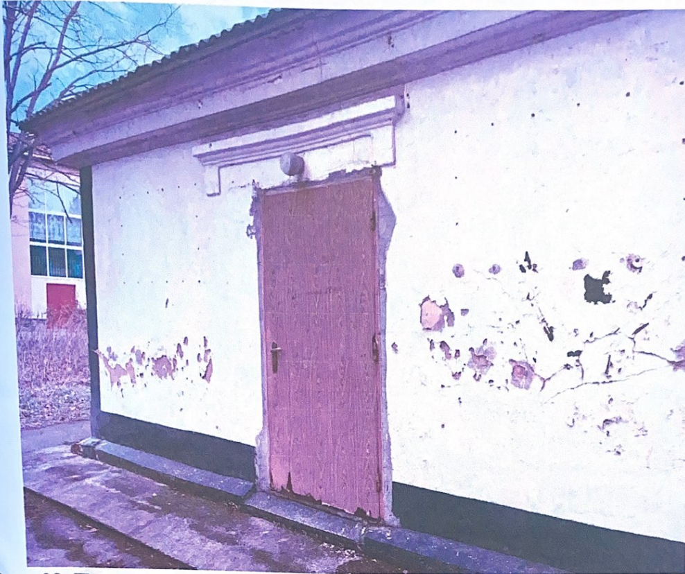
Фото 38: Пошкодження зовнішнього опорядження в осях 1-2, замкання стін через ненормативний ухил вимощення, відсутнє організоване водовідведення (ринви, труби) будівлі старої школи літ. «А».
