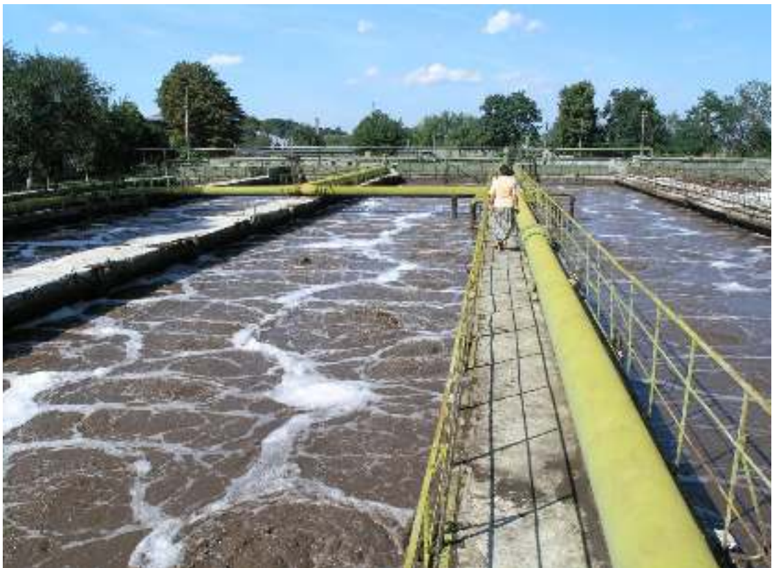
Очисні споруди м. Львова
