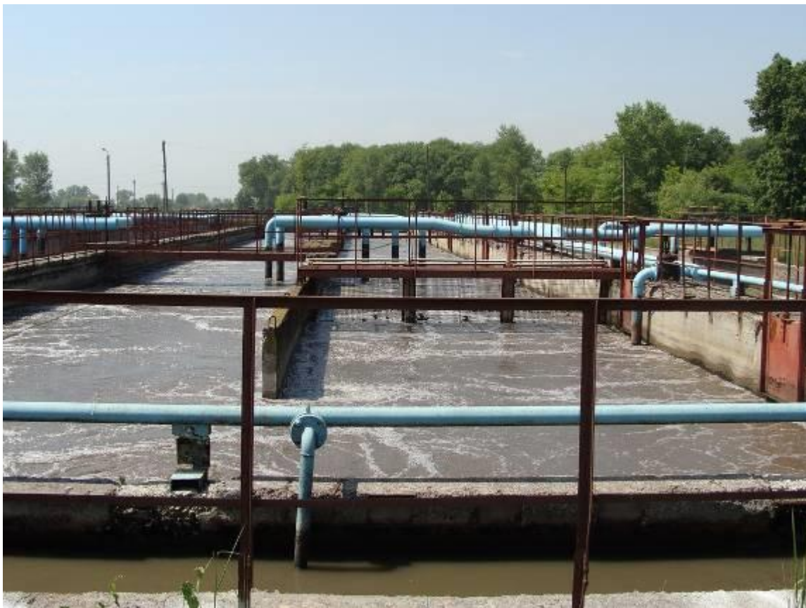
Очисні споруди КП «Чернігівводоканал» Чернігівської міської ради
