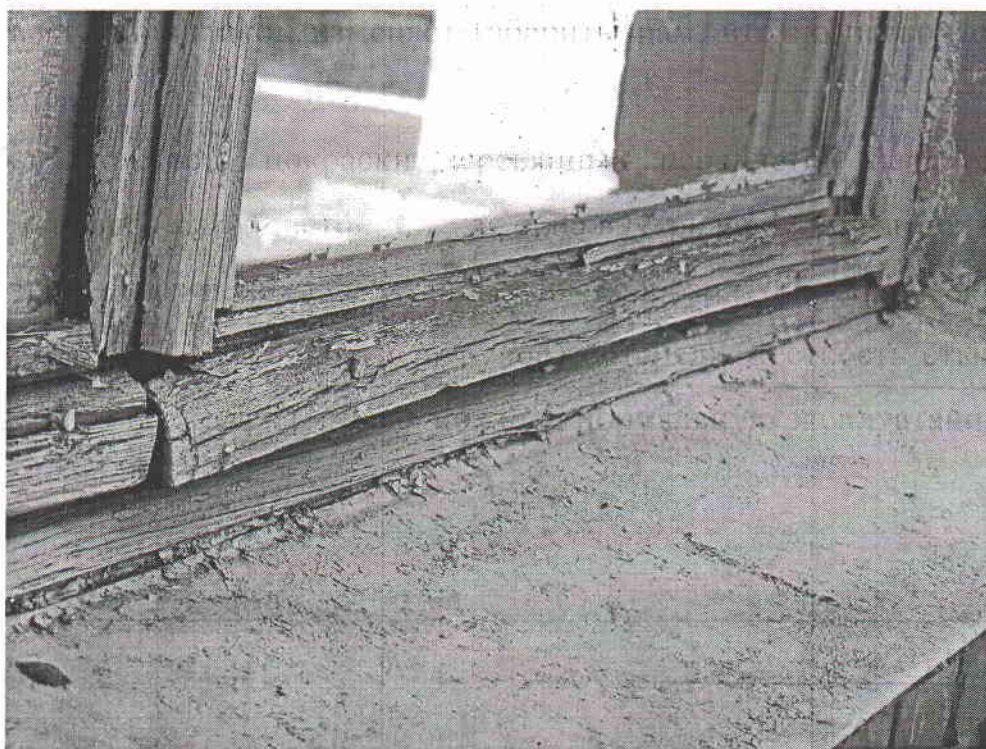
Рис.1. Рассыхание деревянного каркаса наружных рам окон, образование продольных трещин расслоения древесины.
