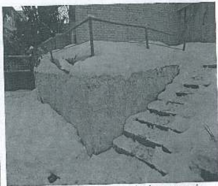
3. Заміни асфальтоване покриття на території закладу(асфальтовані доріжки, частково майданчики) (Асфальтоване покриття має глибокі тріщини, нерівності ,вибоїни, що несе загрозу життю дітей та дорослих)
