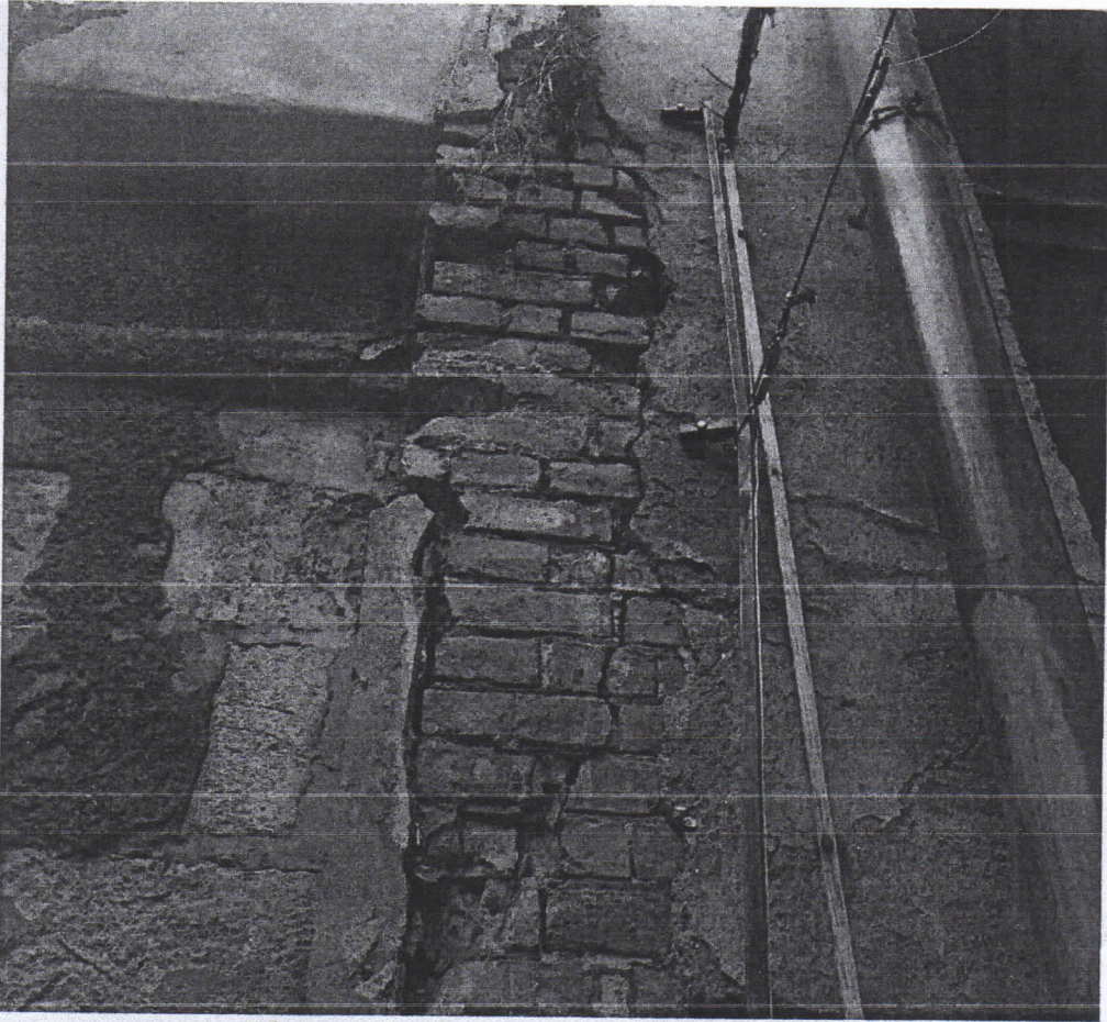
Фрагмент дворової фасадної стіни. Значного розкриття вертикальна тріщина.
