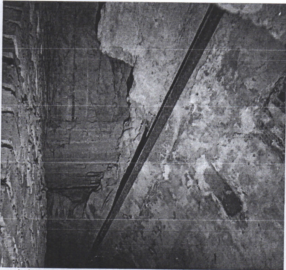
Фрагмент стелі підвального приміщення. Обвалена частина склепіння до плит перекриття поруч із шахтою ліфту.
