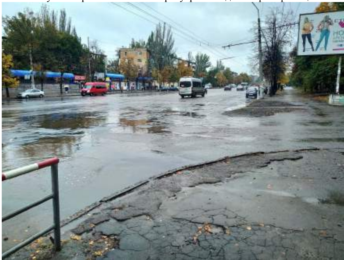
Фото 1. Стан проїзної частини на примиканні (деформація покриття, бортових каменів, ненормативний поперечний похил)
