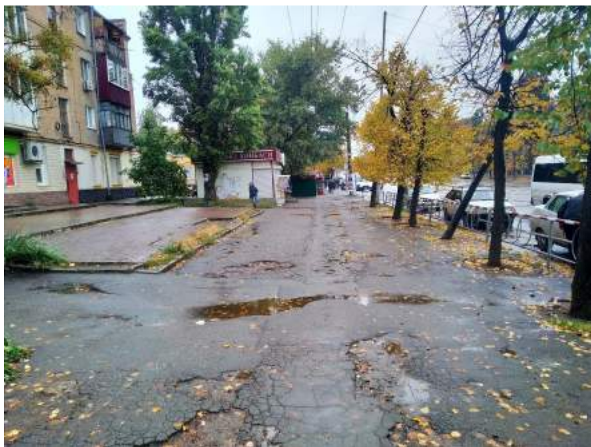
Фото 5. Стан пішохідної частини тротуару (деформація покриття)
